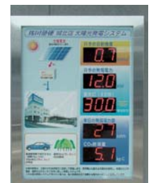
運転状況を確認できる表示パネル
